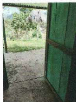
Foto 4: Piso de concreto deteriorado.
