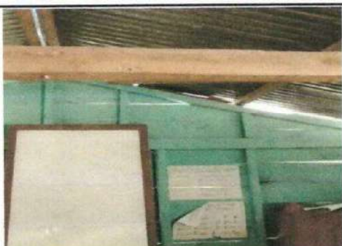
Foto 3: Paredes con deterioro y sin mantenimiento.
