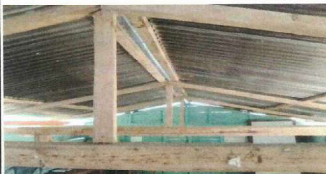
Foto 2: Vista de la estructura de techo visiblemente con deterioro por humedad.
